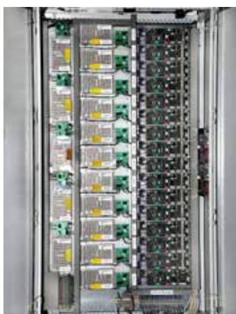
Armoire électrique principale puissance comprenant la puissance, les automats de commande de ligne, l'alimentation basse tension.
