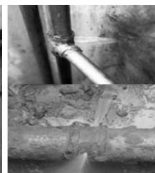
Système d'extincteurs automatiques
