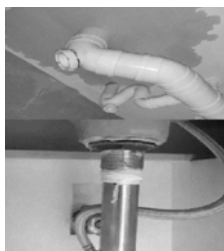
Fuites de tuyaux d'alimentation en eau/tuyaux d'eau
