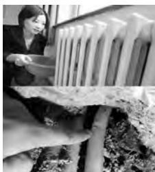
Fuites de tuyaux de chauffage/tuyaux de chauffage par le sol
