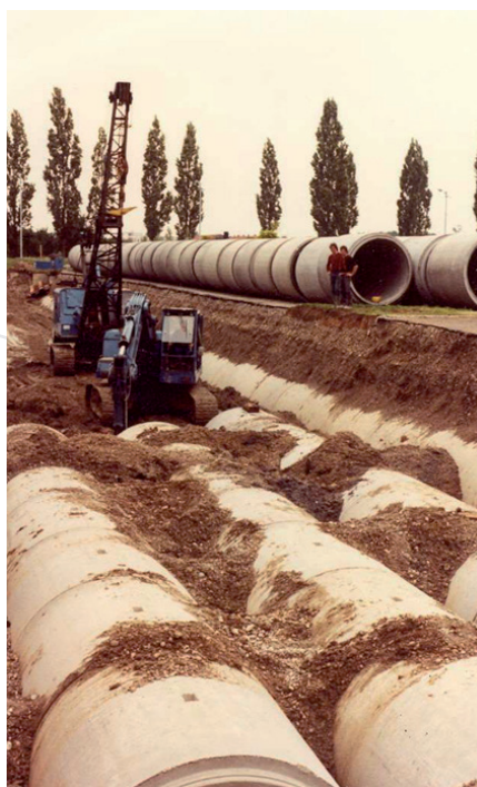
Figure 29 – Exemple de pose multiple de canalisations de grand diamètre, sans respect des distances entre tuyaux
