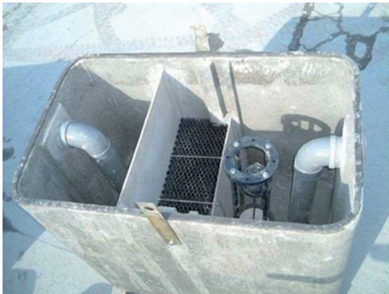
Figure 43 - Séparateur de liquides légers
