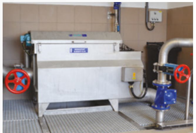
Station d'épuration Chomech, République tchèque, 2FBO
