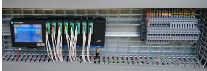
Solution Wixia dans l'armoire électrique
