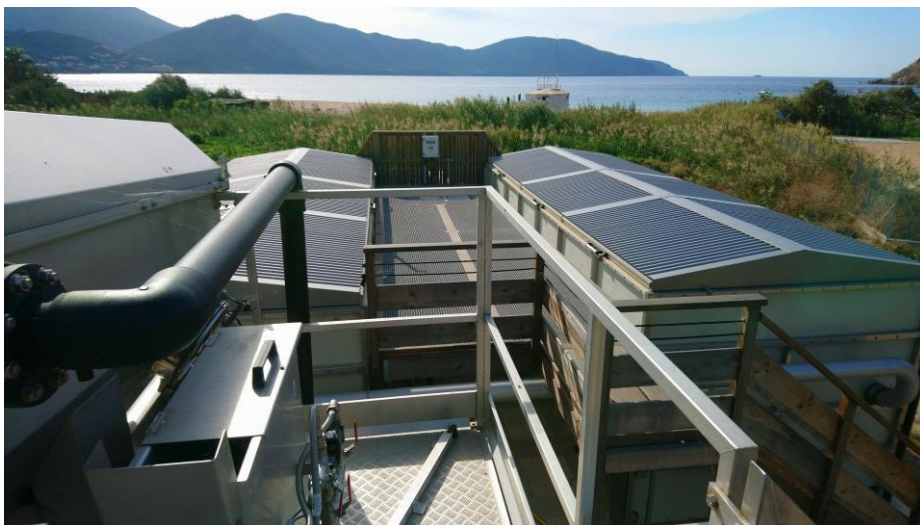
Station d'épuration de Lava et sa vue imprenable sur le golfe
