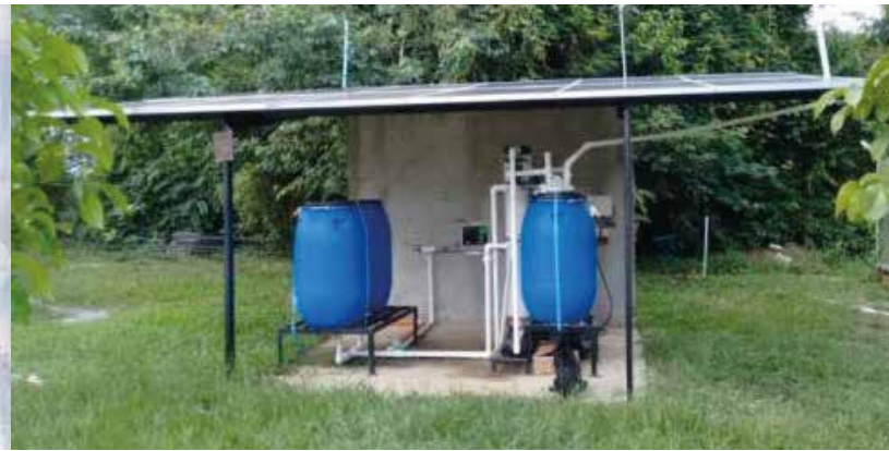
Unit C1, with photovoltaic panels, COLOMBIA Unité C1, avec panneaux photovoltaïques, COLOMBIE
