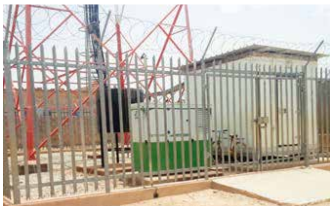
Emergency generating set on telecommunication tower Groupe électrogène secours sur pylône téléphonique
