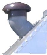
Ventilation de toit
