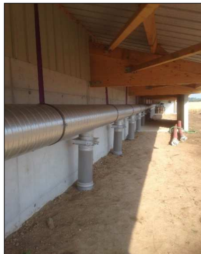
Collecteurs d'air avec caniveaux de ventilation
