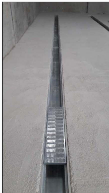
Caniveaux de ventilation
