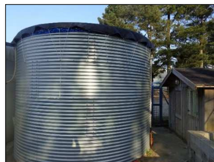
Réserves d'eau de pluie
