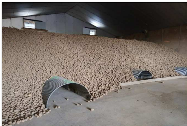
Ventilation pommes de terre par gaines
