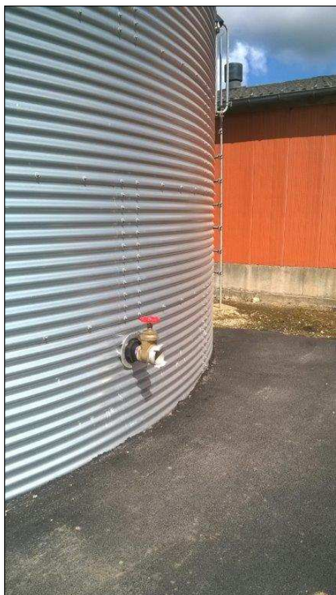
Réserves incendie (sortie directe)
