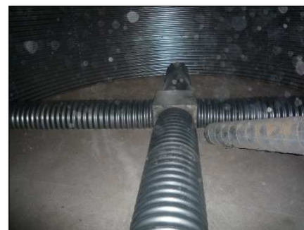
Ventilation par gaines hors sol
