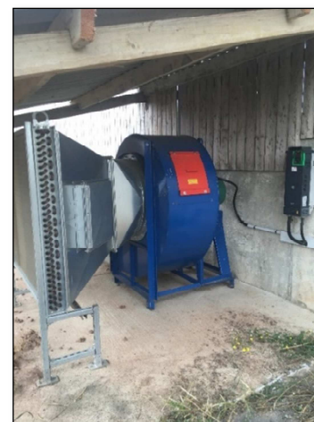
Ventilateurs, batteries chaudes, variateurs de fréquence
