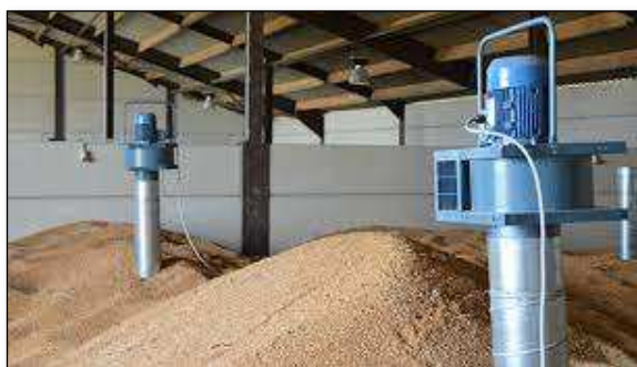
Colonnes de ventilation et vis point chaud
