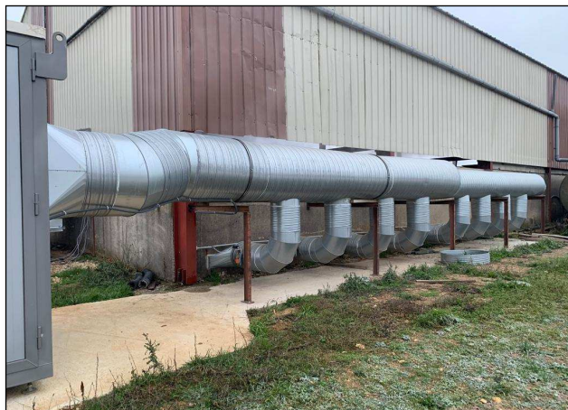
Collecteurs d'air avec plancher perforé carrossable
