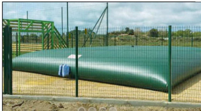
Réserves souples incendie
