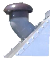
Ventilation de toit
