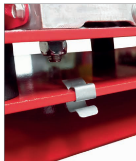
Passe-câble pour une protection du câble d'éclairage
