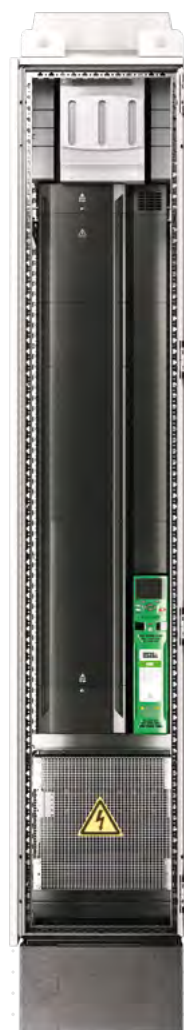
Module de forte puissance dans une armoire pré-assemblée
