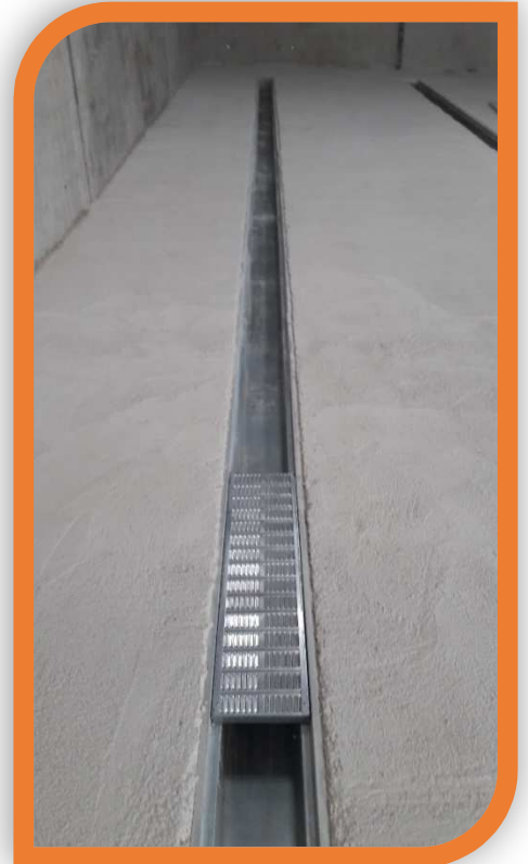
Caniveaux de ventilation
