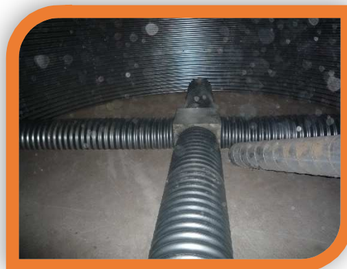
Ventilation par gaines hors sol
