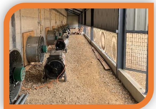
Générateurs d'air chaud
