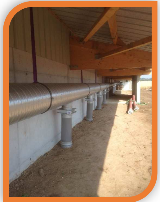
Collecteur d'air avec caniveaux de ventilation
