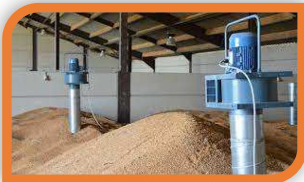
Colonnes de ventilation et vis point chaud
