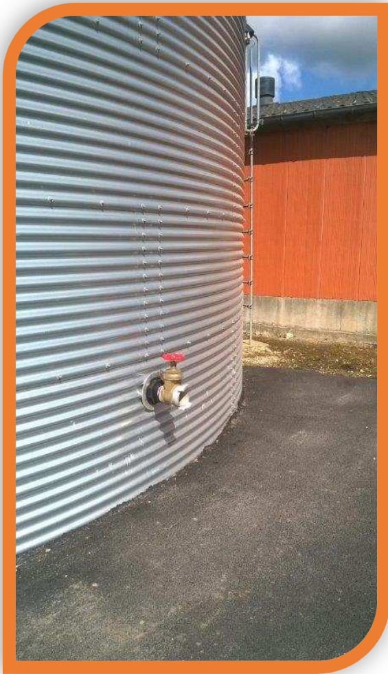
Réserve incendie sortie directe
