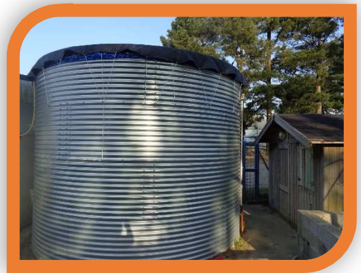
Réserve d'eau de pluie
