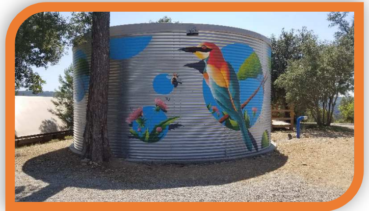
Réserve incendie + colonne incendie
