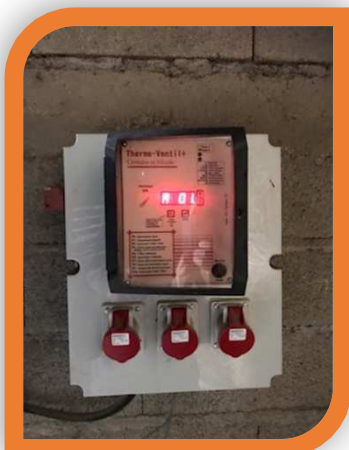
Régulation stockage précaire
