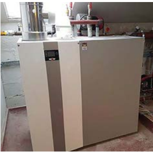
POMPE À CHALEUR & CHAUDIÈRE
