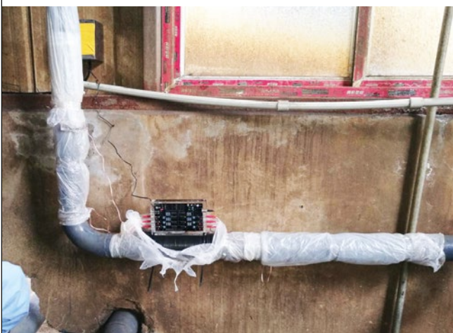
Vulcan S100 a été installé dans la salle des eaux usées afin de traiter la machine de déshydratation des boues.
