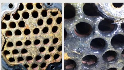
Faisceau tubulaire d'un échangeur de chaleur
