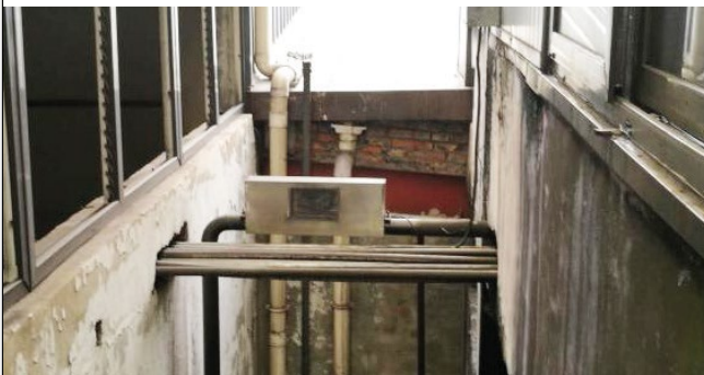
Installation de Vulcan S25 à l'extérieur.
