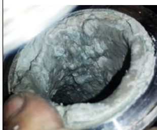
Avant l'installation de Vulcan : Le tuyau était recouvert de dépôts de calcaire.
