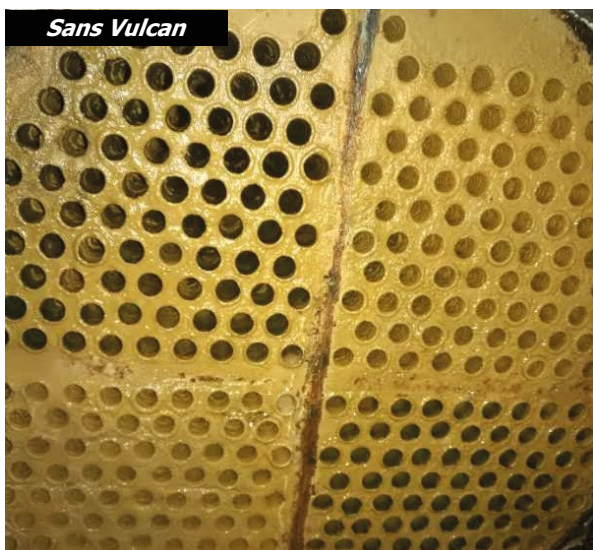
Avant d'installer Vulcan, le calcaire était très épais et dur au niveau des tubes de l'échangeur de chaleur.
