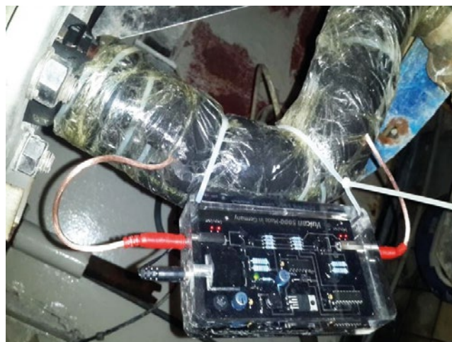
Vulcan 5000 a été installé sur la conduite principale de la salle de recyclage des eaux.
