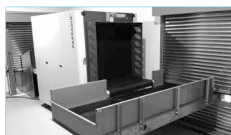
Machines de sûreté contrôle bagages en soute
