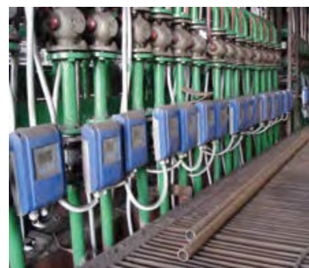
Détection de fuite dans les lignes de refroidissement des fours de fusion et aciéries
