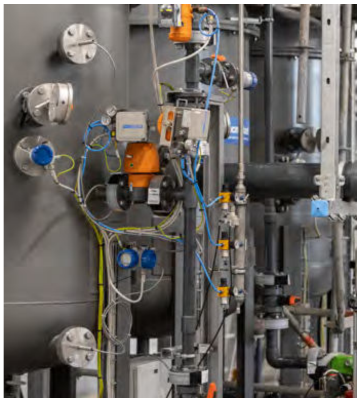
Mesure de niveau dans une cuve sous pression
