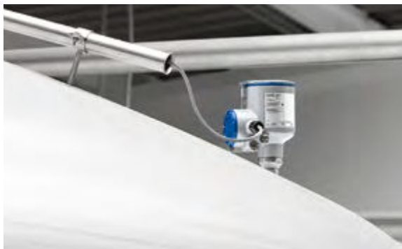
Mesure de niveau dans une cuve de lait
