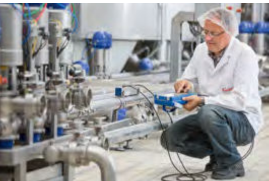
Mesure de débit temporaire avec débitmètre pour montage externe dans une laiterie
