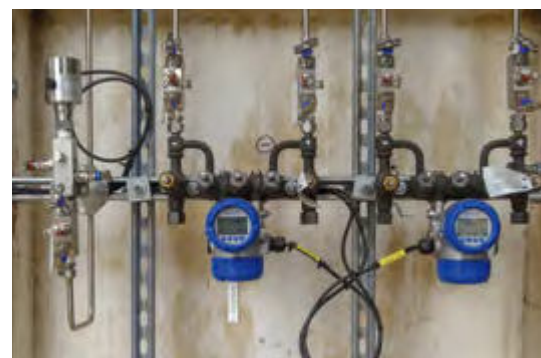
Transmetteur de pression dans une centrale biomasse
