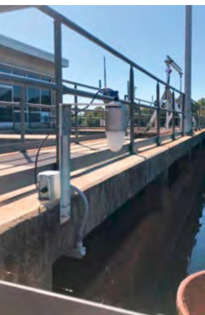
Mesure de niveau radar du bassin d'eau
