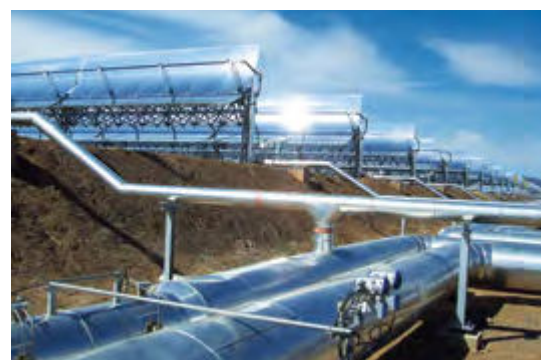
Mesure du débit d'huile thermique dans une centrale solaire thermodynamique
