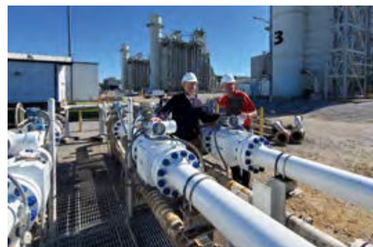
Mesure du débit pour transactions commerciales pour un système de gaz naturel
