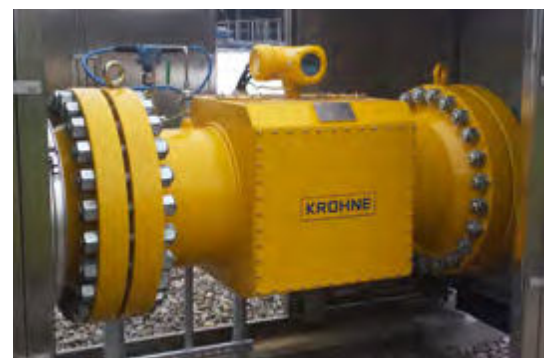
Comptage transactionnel pour une station bidirectionnelle de comptage de gaz naturel à la frontière
