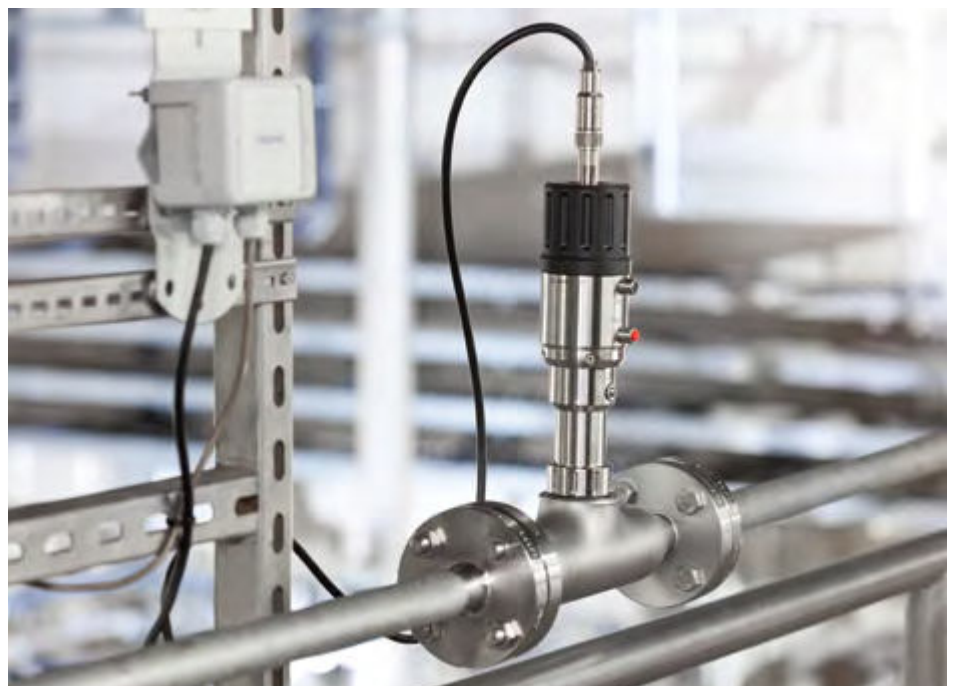
Support rétractable manuel pour sonde de pH dans une usine de produits chimiques
