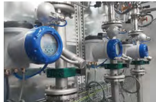
Mesure de débit de gaz naturel et d'oxygène pour le contrôle de la combustion
