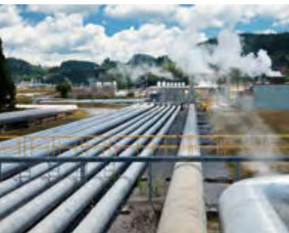
Système de mesure de vapeur géothermique
