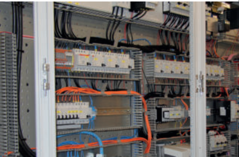
Armoire de commande
