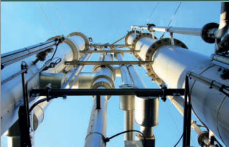
Epuration du biogaz
