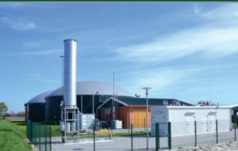
Installation de biométhane
