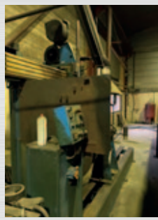
POSTE DE SOUDURE AUTOMATIQUE
