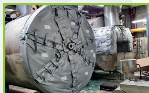
Façade de chaudière
