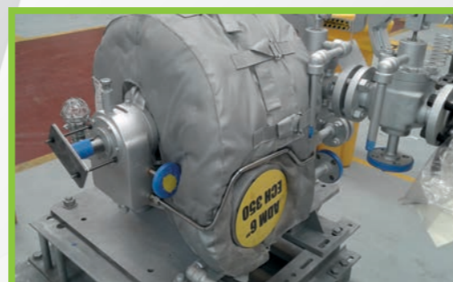
Matelas en forme sur turbine vapeur
