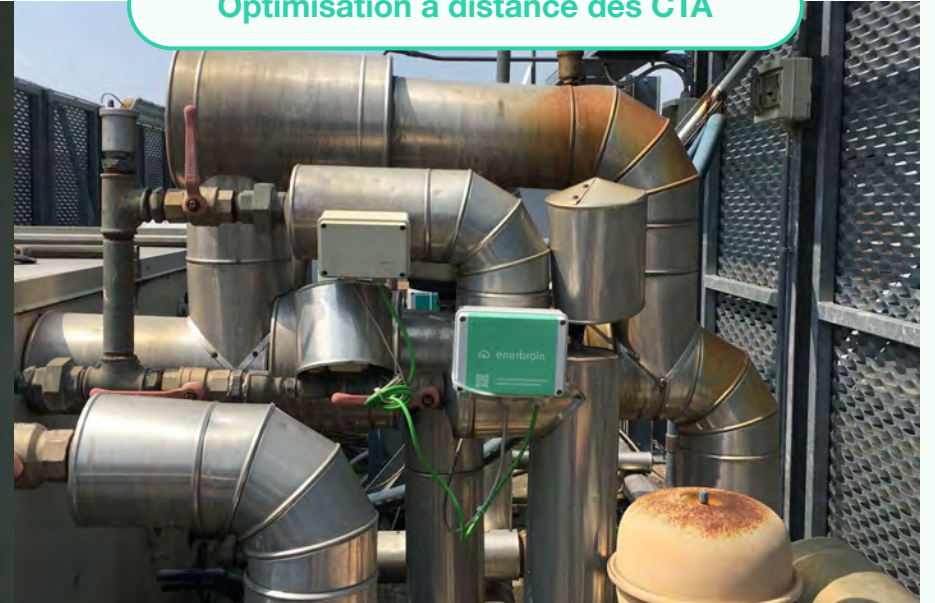
Optimisation à distance des CTA
