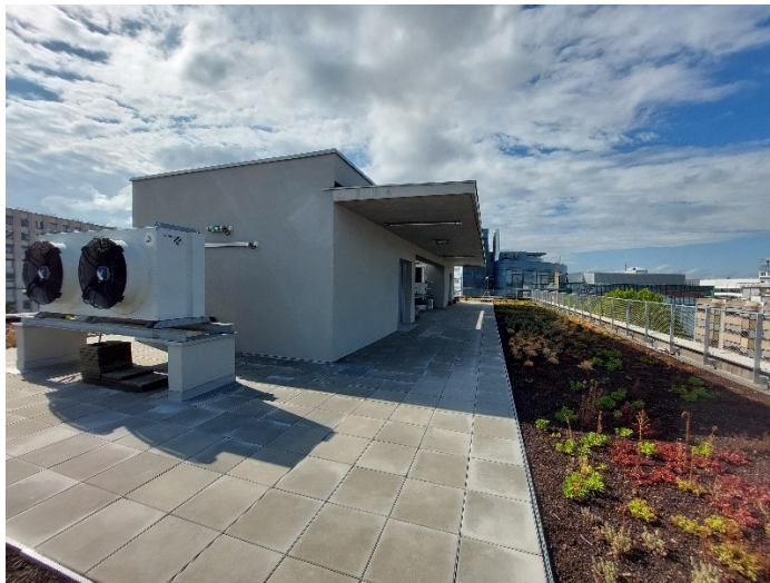
Aéroréfrigérant en toiture
