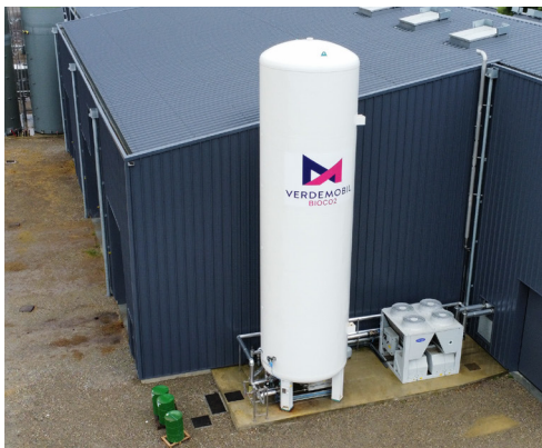
Agrogaz Fontrailles (65) 3 700 tonnes par an
