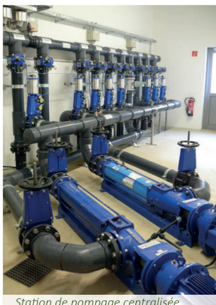
Station de pompage centralisée
