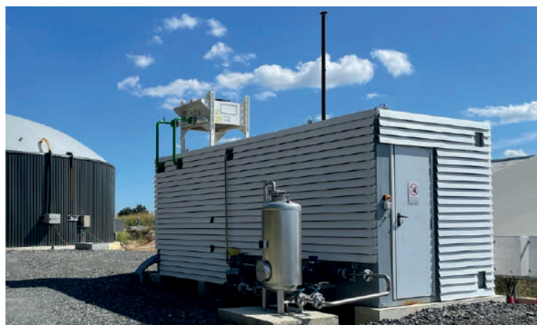
Autoconsommation d'électricité par cogénération
