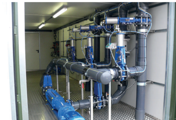
Station de pompage et automatisme en conteneur
