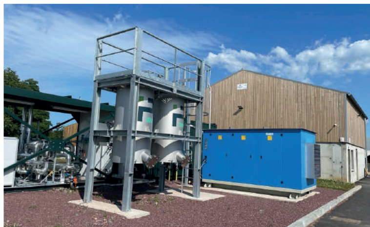
Système d'épuration Prodeval
