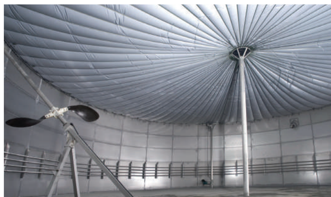
Intérieur d'un digesteur en acier inoxydable
