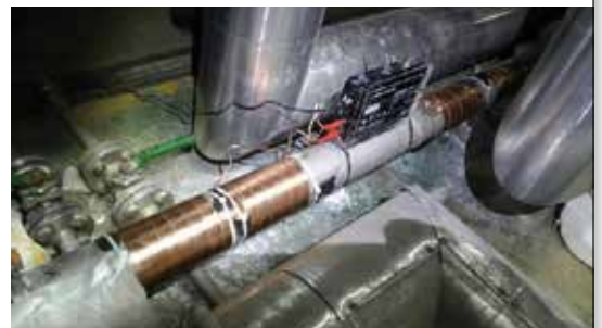
Vulcan S25 installé chez Toray Industries
