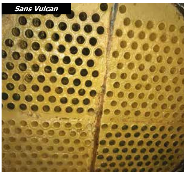
Avant d'installer Vulcan, le calcaire était très épais et dur au niveau des tubes de l'échangeur de chaleur.
