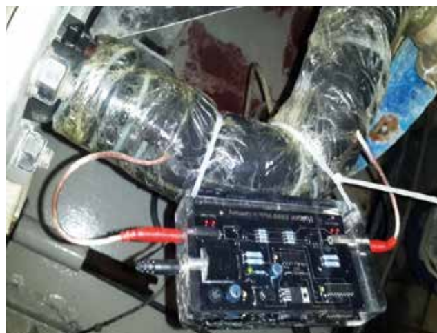
Vulcan 5000 a été installé sur la conduite principale de la salle de recyclage des eaux.
