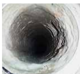
2 semaines après l'installation de Vulcan, le calcaire s'est amolli et est tombé.
