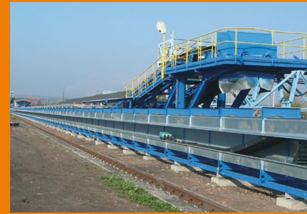
La plus longue course au monde avec une chaîne porte-câbles : 615 m dans une centrale à charbon
