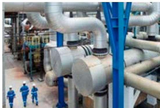
Raffinerie de Grandpuits
