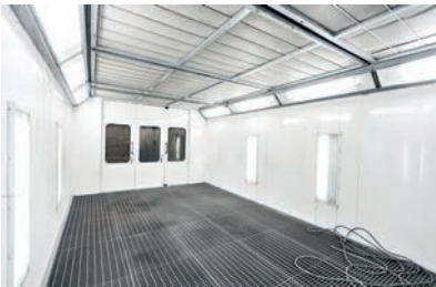
Nettoyage des cabines de peinture
