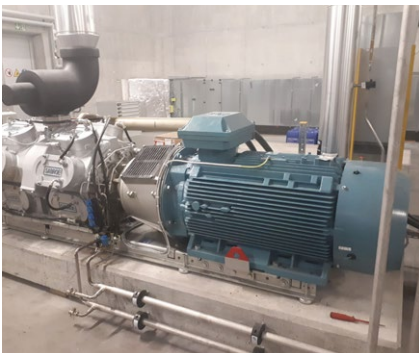
HLK-Anlage bei einem Grossverteiler, Bayer AG, SIX AG
