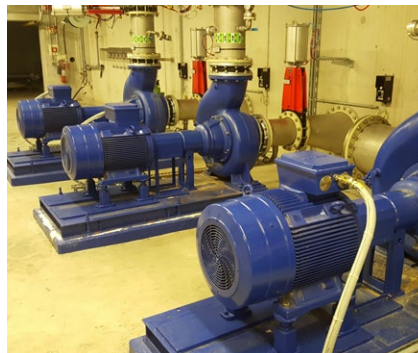
Zentrifugen und Pumpen in der Wasserbehandlung
