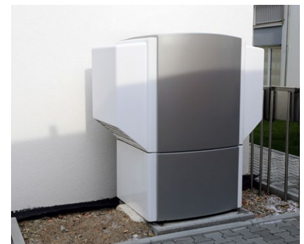
Wärmepumpen oder Wasserpumpen mittels IoT-Lösungen überwachen
