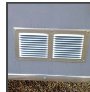
Grille d'aération basse
