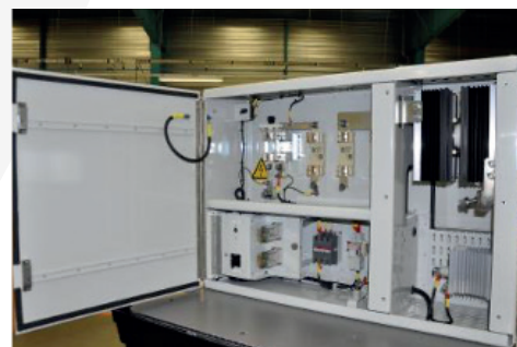
Platine électrique secteur ferroviaire
