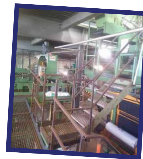
Modification de l'accès à la partie supérieure avec suppression de l'échelle à crinoline
