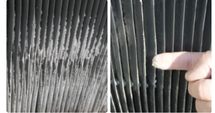
Grille d'une tour de refroidissement
