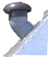
Ventilation de toit
