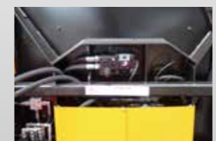
Moteur direct sur la turbine
