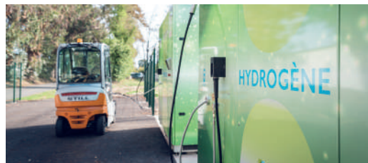
BORNES DE RECHARGE ÉLECTRIQUE ET INFRASTRUCTURES GNV OU H2 POUR LES VÉHICULES LÉGERS, UTILITAIRES, DE MANUTENTION OU CAMION
