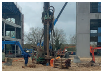
CENTRALE DE GÉOTHERMIE
